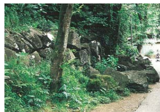
石垣の被害例
