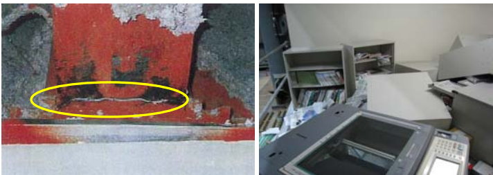
梁端の下フランジが破断 長く続く長周期地震で予想される被害例
